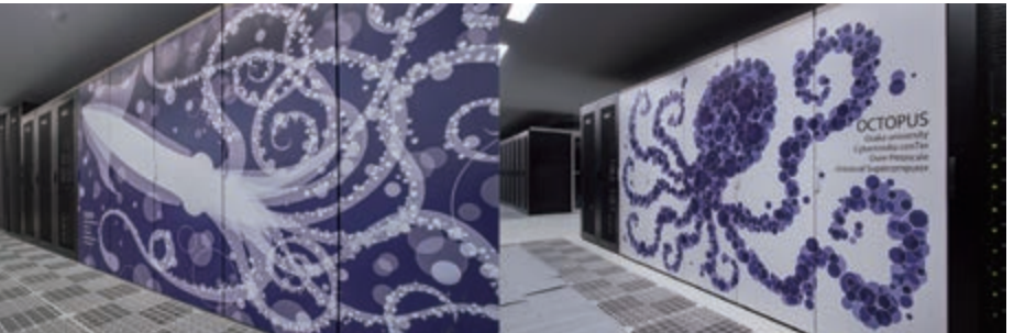
図 サイバーメディアセンターのスーパーコンピュータ
