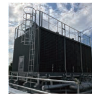
外気温に近い冷却水を作るフリークーリングタワー
